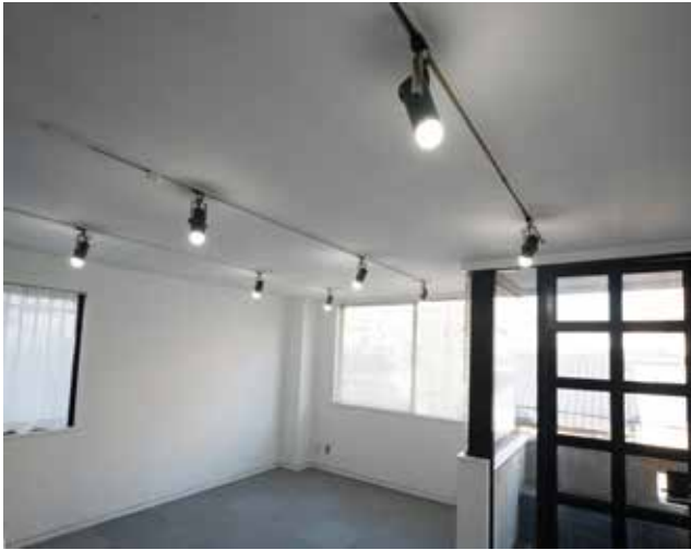
入り口付近には移動可能なレール電源で角度調整のできるデザイン的な黒のダウンライト（LED電球付）が8個あり明るさは十分です。
