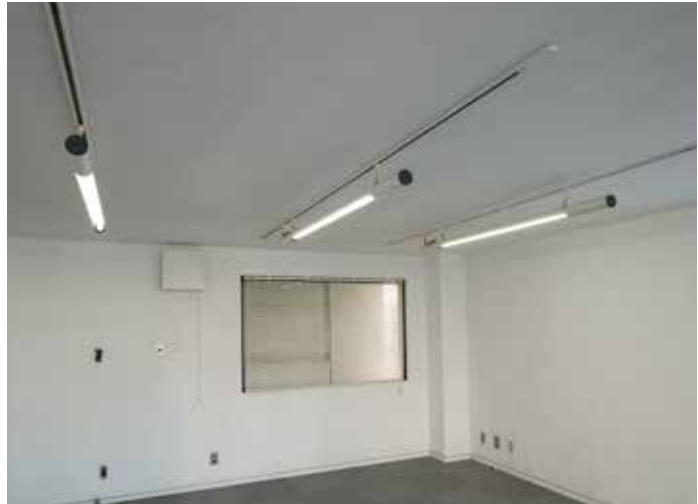
奥側はスタイリッシュな蛍光灯が3灯ありレール電源なので移動も可能です。
